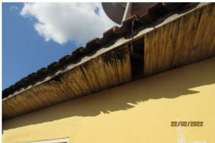
FOTO Nº 16 Beiral de madeira avariado na área livre
