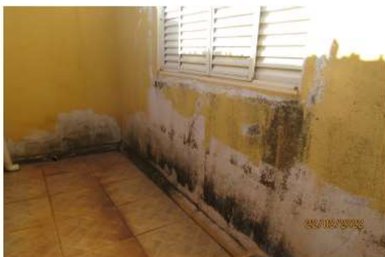
FOTO Nº 15 Aspecto localizado de paredes, esquadrias e piso, área livre dos fundos
