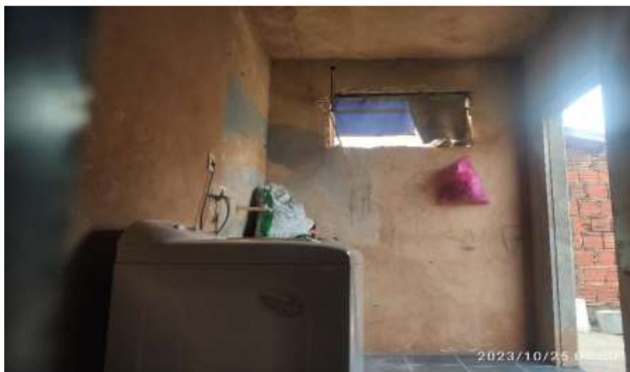
Esta foto comprova a falta de acabamento da área de serviço
