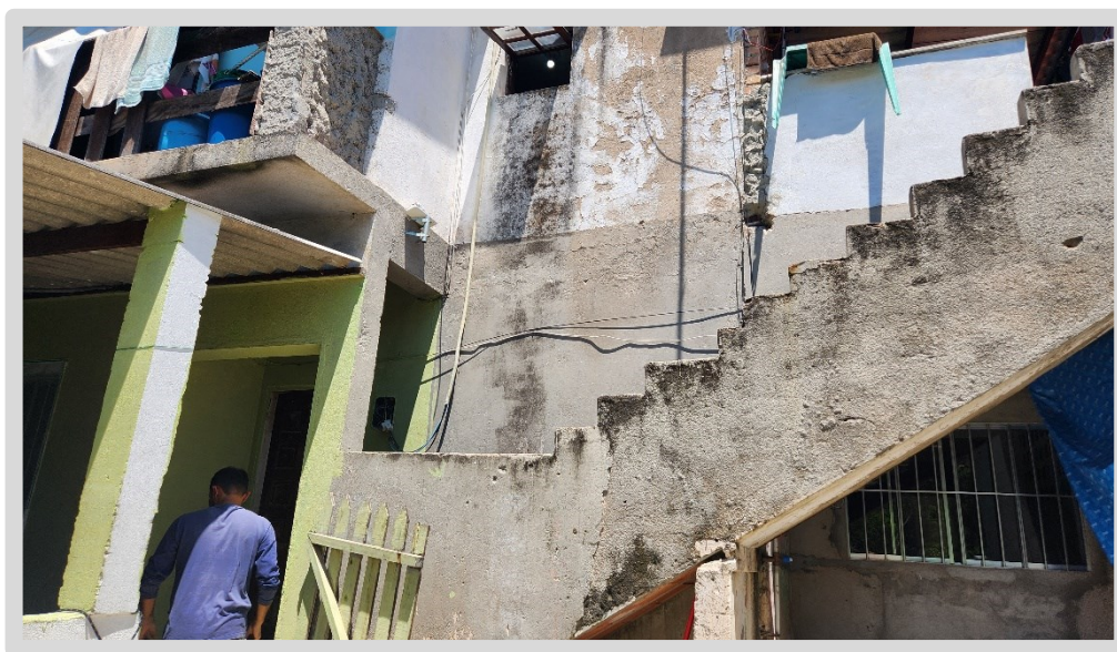
Vista externa do imóvel avaliando a partir do quintal, casa padrão econômico necessitando de reparos.
