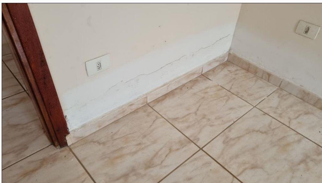
| FOTO 14: Vista aproximada de fissura constatada na alvenaria.
