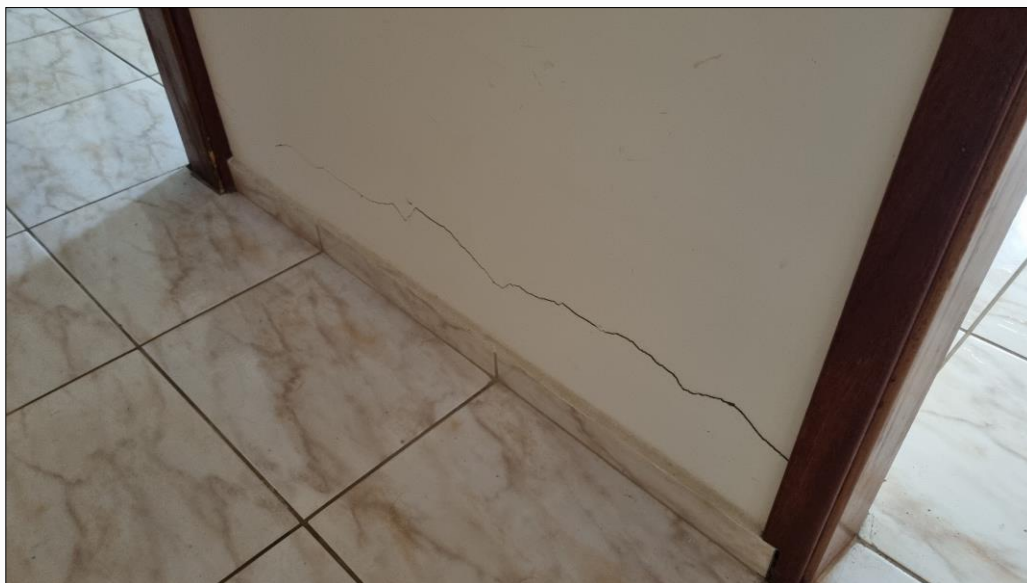
| FOTO 17: Vista geral de danos observados na alvenaria do corredor de circulação.
