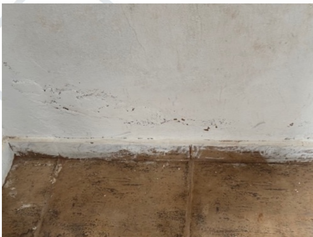
Patologias evidenciadas na edificação
