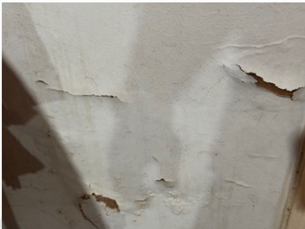
Pontos de patologias evidenciados na área dos dormitórios
