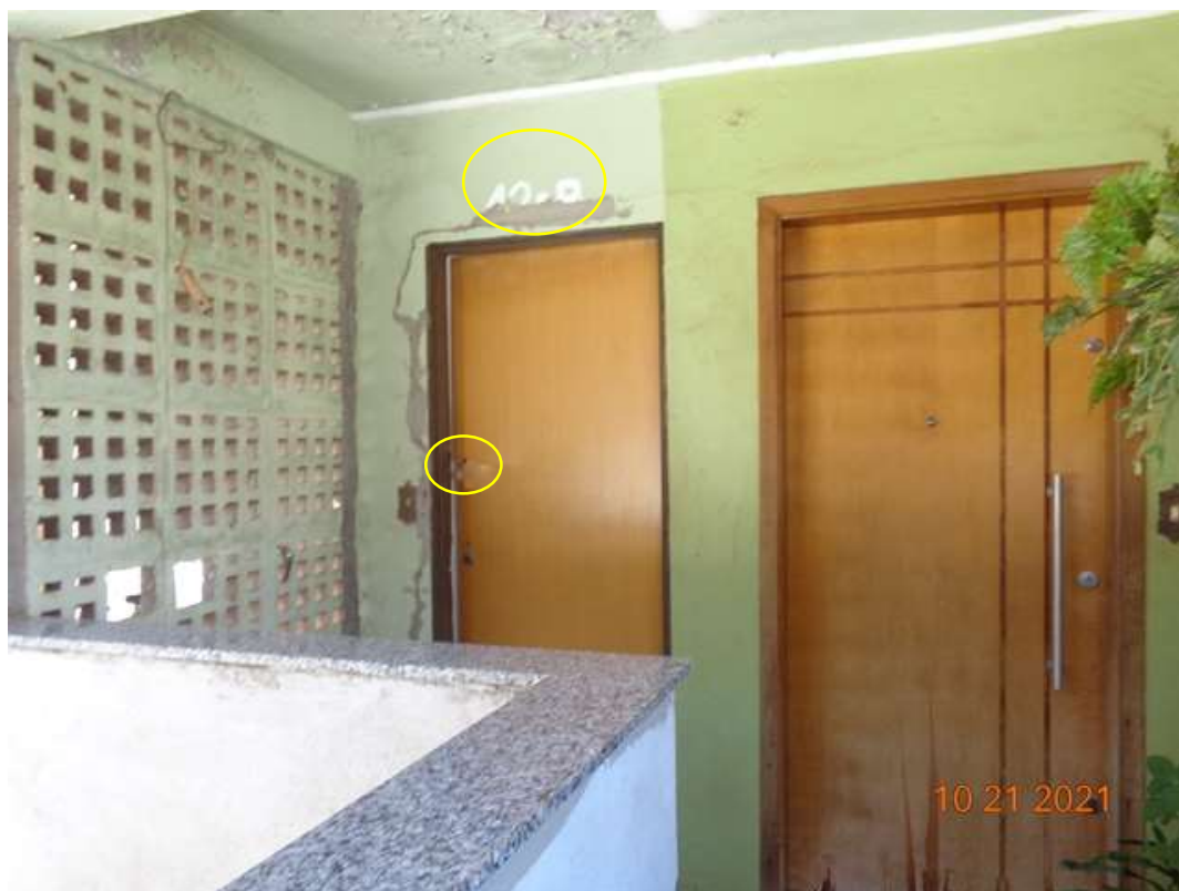
Foto 2 – Detalhe da porta de entrada do imóvel. Encontramos a fechadura com sinais de arrombamento
