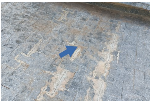
Fig. 17 Tentativa de correção de infiltração na laje
