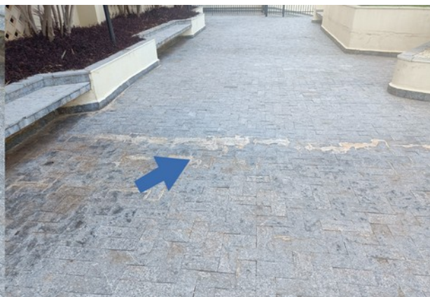
Fig. 18 Tentativa de correção de infiltração na laje
