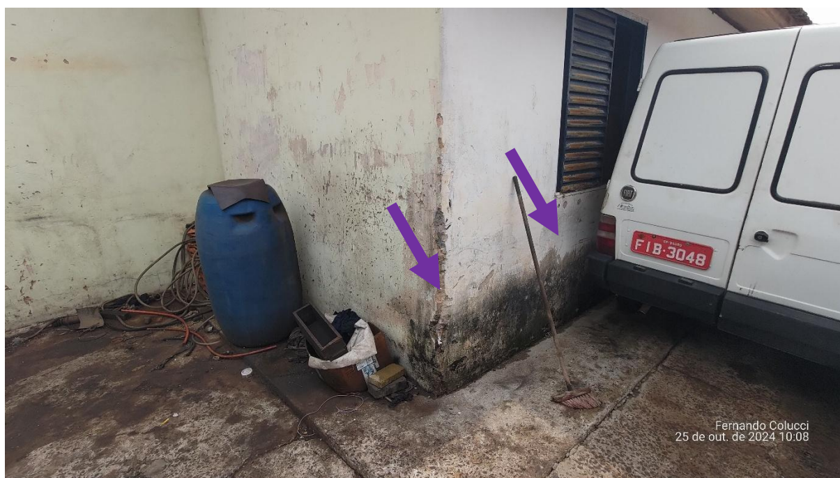
Figura 39 - Manchas de umidade ascendente
