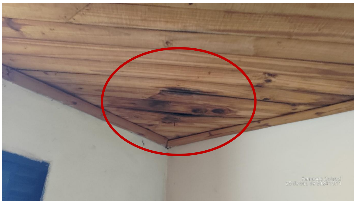
Figura 26 - Presença de umidade no forro
