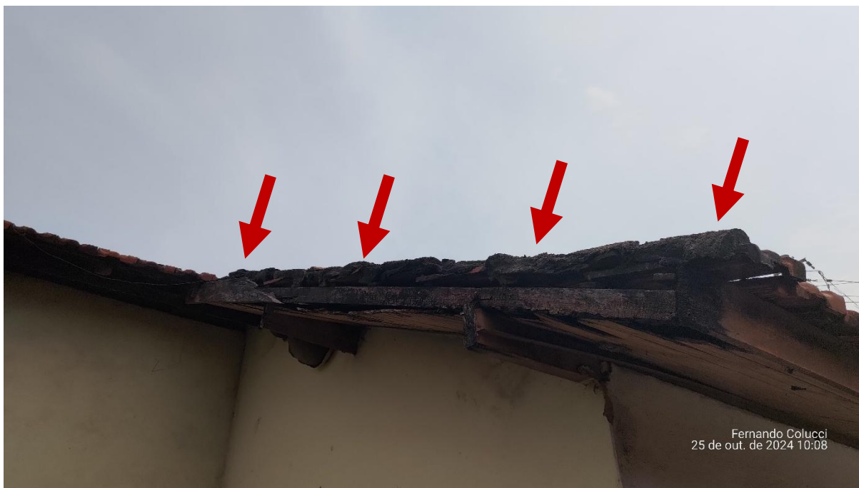
Figura 24 - Apodrecimento da estrutura do telhado
