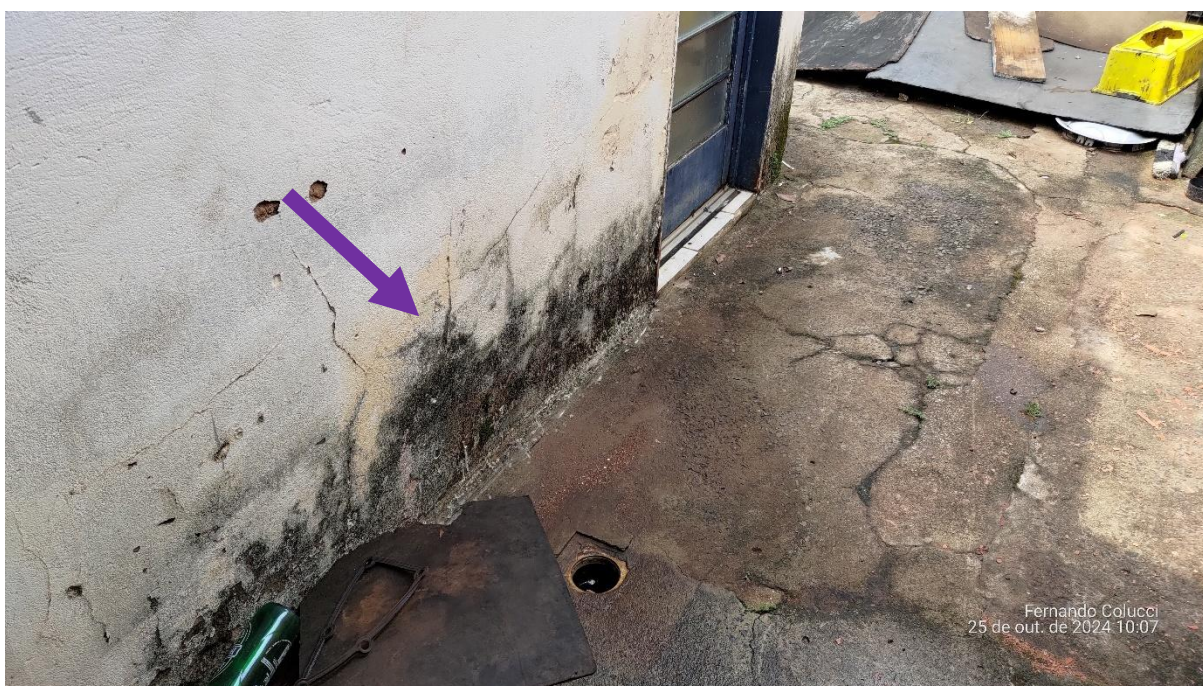
Figura 37 - Manchas de umidade ascendente
