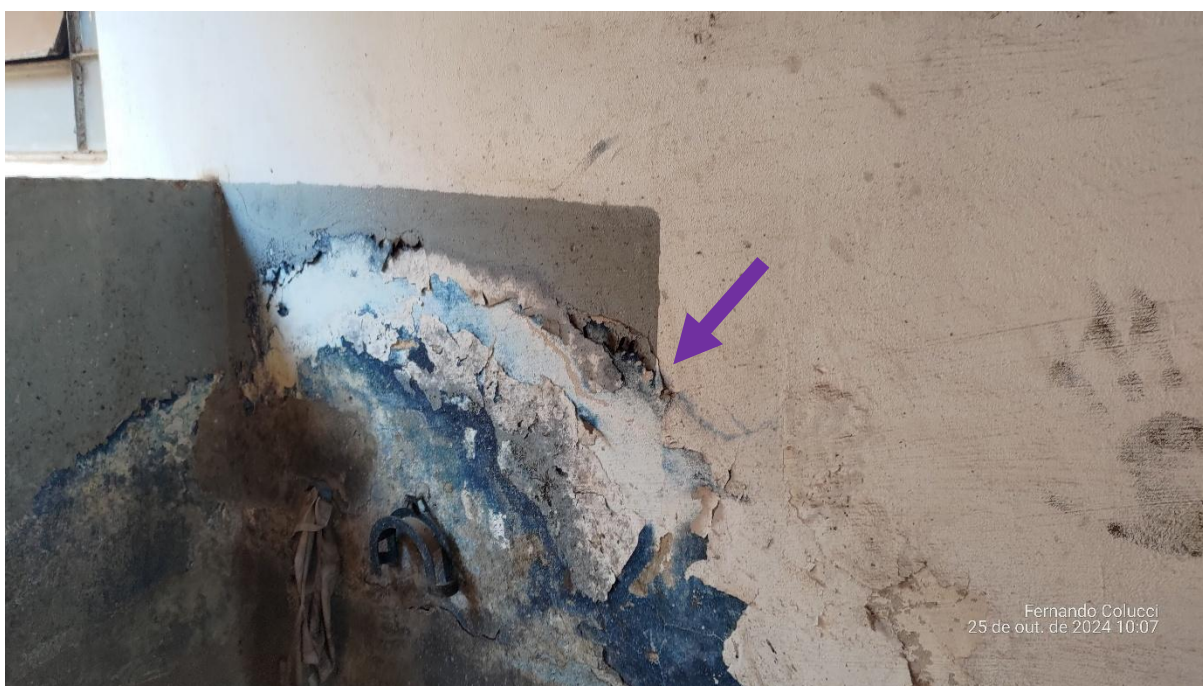
Figura 35 - Descascamento da pintura
