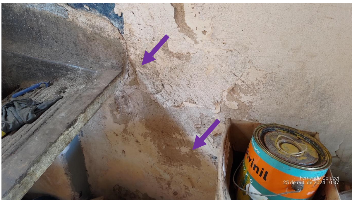
Figura 36 - Descascamento da pintura
