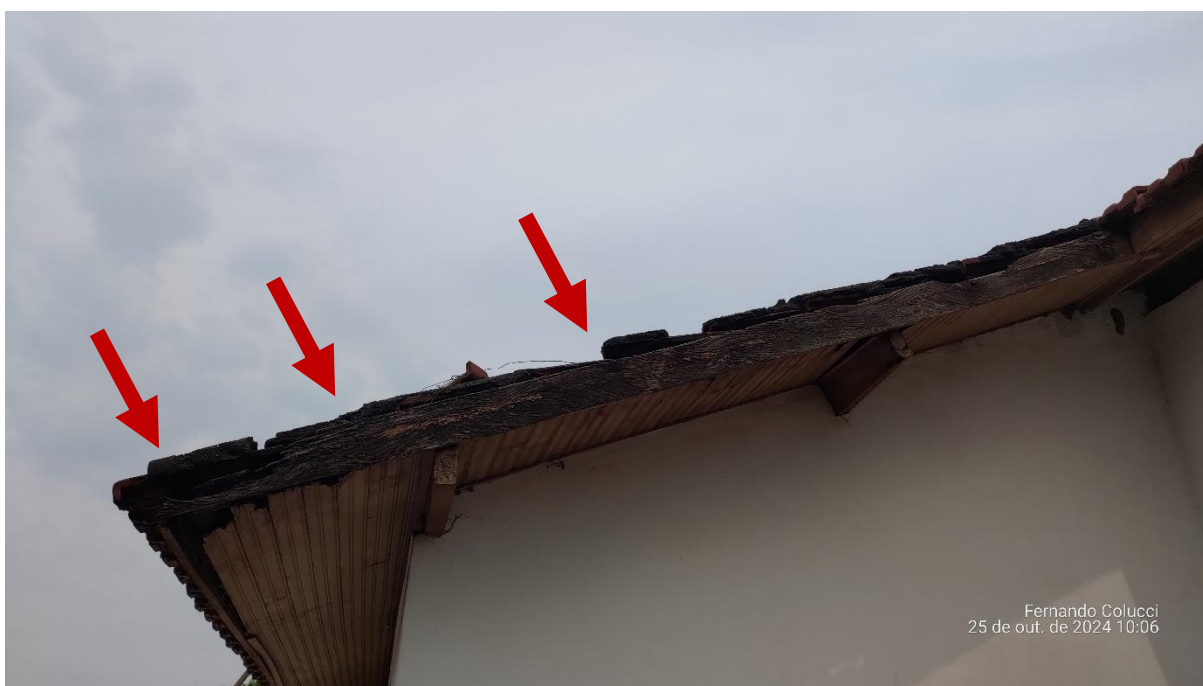
Figura 21 - Madeiramento e Forro em estado de apodrecimento
