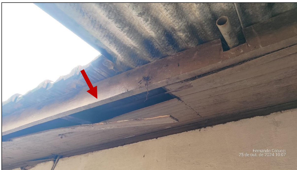
Figura 22 - Forro do beiral com problemas
