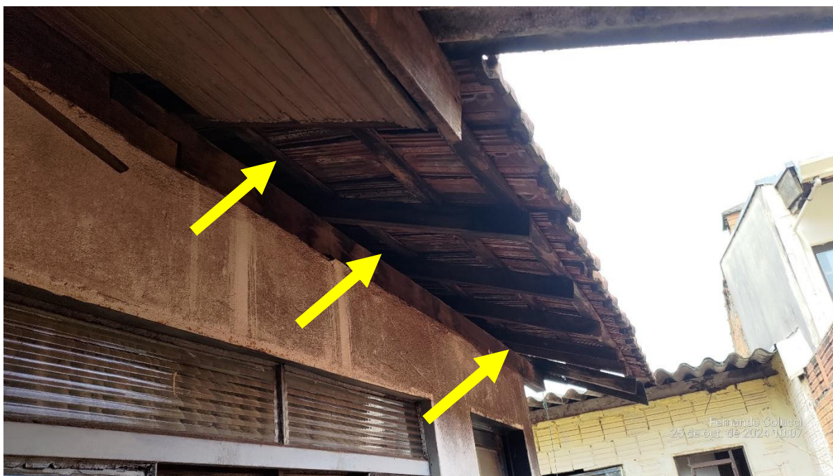
Figura 23 - Queda do forro de madeira
