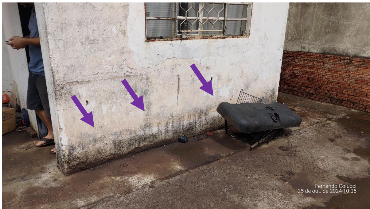
Figura 33 - Manhas de umidade ascendente
