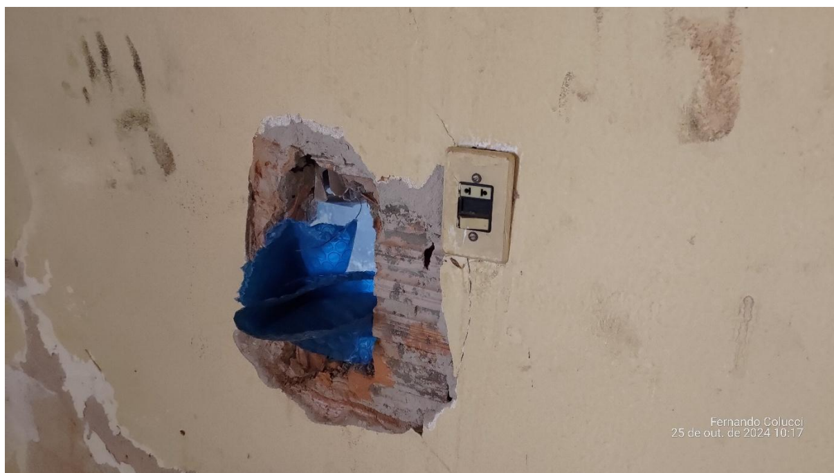
Figura 32 - Abertura na parede do banheiro visível pela cozinha
