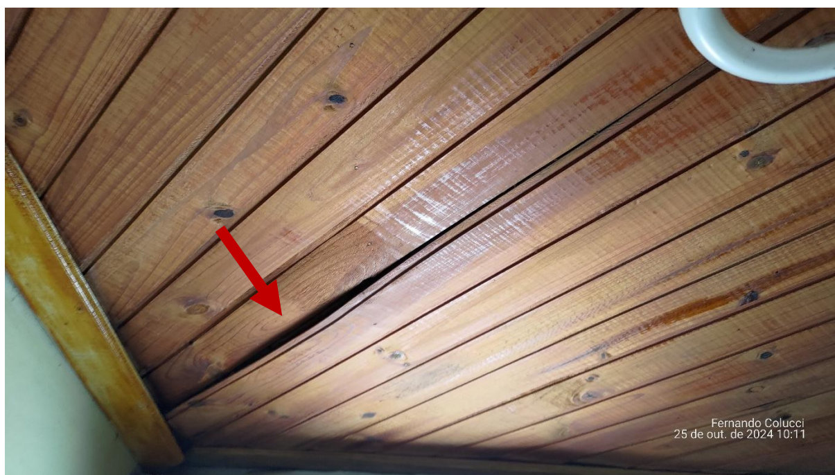
Figura 25 - Forro interno deformado
