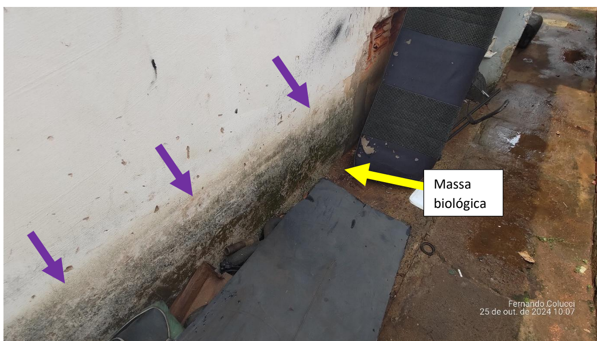
Figura 34 - Manhas de umidade ascendente com presença de massa biológica
