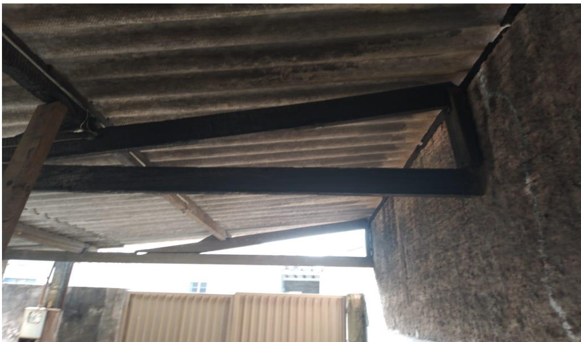
Fig. 15: Estrutura telhado garagem Imóvel Avaliado, comprometida pôr fogo.
