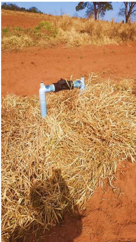
Foto 27. Cavalete para irrigação.
