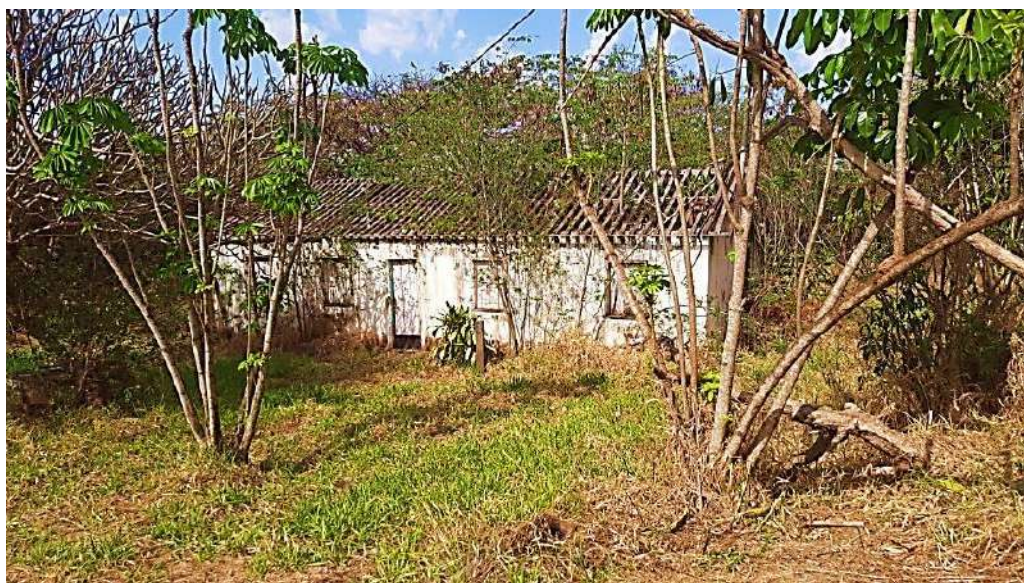
Foto 35. Aspectos de total abandono.
