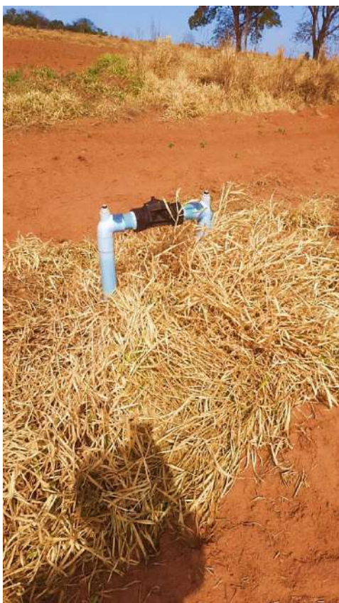
Foto 27. Cavalete para irrigação.
