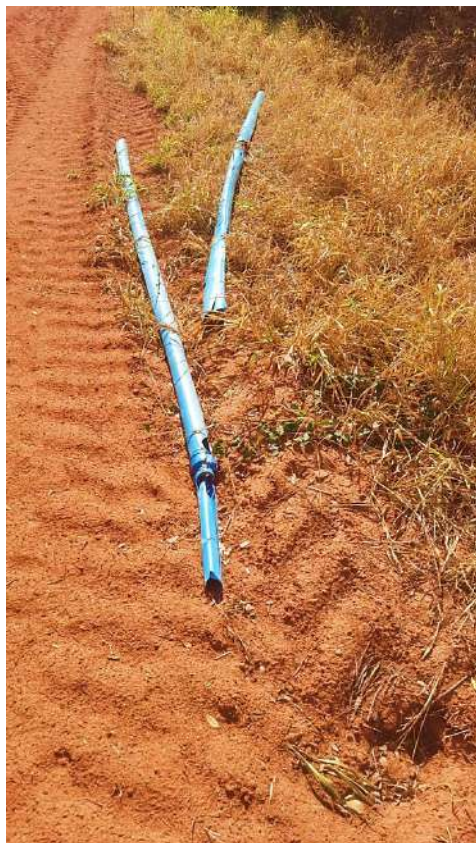
Foto 25. Irrigação que existia destruída.
