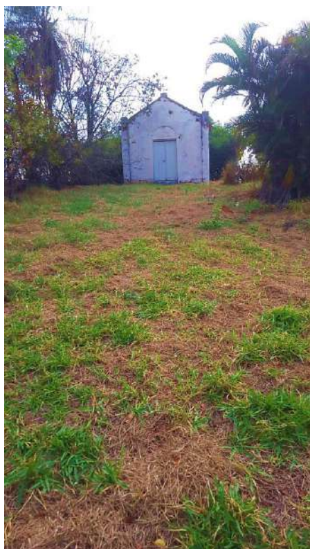
Foto 33. Aspectos de total abandono.
