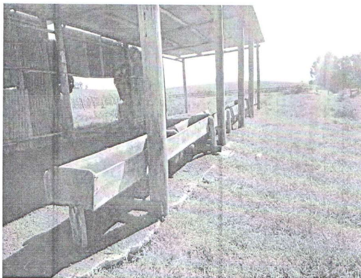
Foto 06: Cocheira com telhas Brasilit laterais com danos e cobertura, cochos de madeira e madeira sem tratamento.
